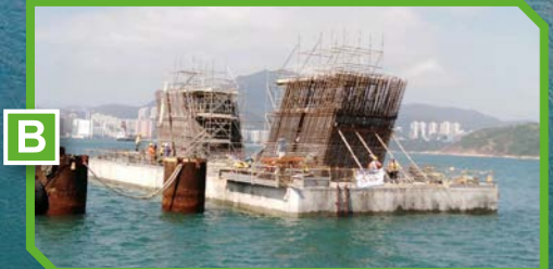
B 於將軍澳灣現場建造 V型橋墩 Cast-in-situ V-pier at Junk Bay
